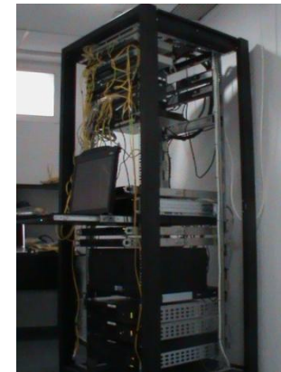
Subsol: Centru de Date și Centrala Telefonica
